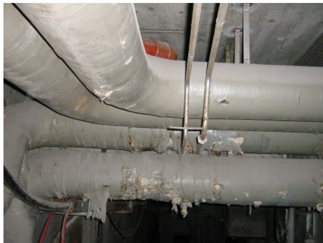
Détection d'amiante faiblement aggloméré dans les plâtres de calorifugeage par nos spécialistes agréés
